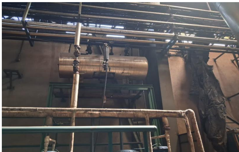
شکل ۶ هوایی نمودن خطوط برگشت آب صنعتی
